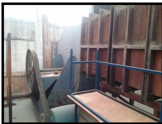
Figura 6.3: Detalhe ventilador radial. Fonte: LabMFA –UFRJ.
